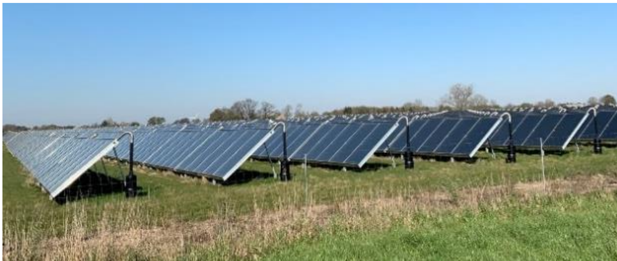
Figur 10 Solvarmeanlæg fra Fuglebjerg Fjernvarme
